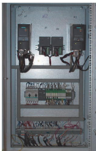
Рис. 3. Шкаф управления электроприводом
